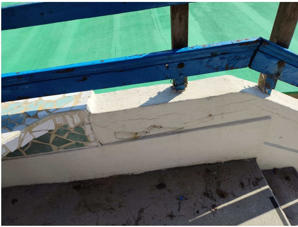
Piastrina metallica di supporto al mancorrente in legno Con deterioramento dell'intonaco in conseguenza del rigonfiamento del metallo arrugginito
